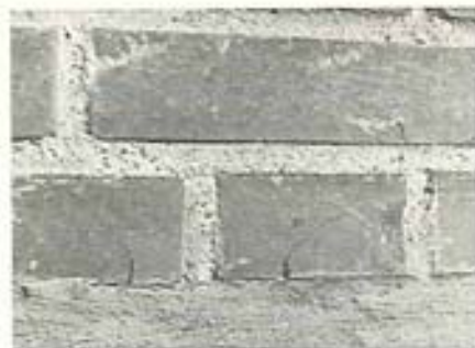
Fig. 8.29. Sammentrykning af paplag bag sokkelpuds har ført til spændingskoncentration og afsprængning ved stenenes forkant.
