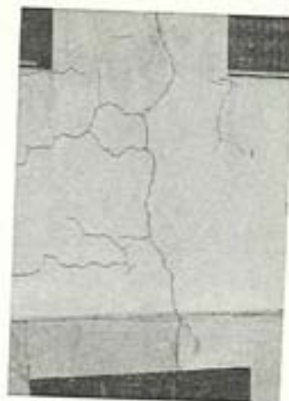
Fig. 2.28. Gennemgående svindrevner i muret væg.
